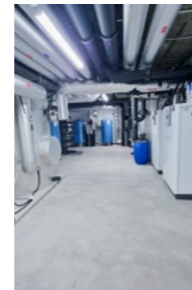
Energieverbund Uitikon Allmend Uitikon Hälg & Co. AG Zürich
